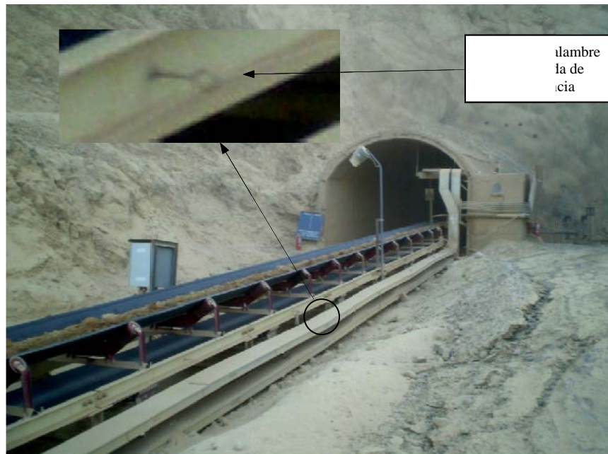
Ilustración 13 Salida de cinta transportadora de la trituración primaria
